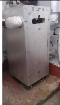
Varmeveksler for rumvarme Teknisk økonomisk levetid 25 år
