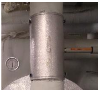
Clorius temperaturventil til styring af varmtvandsproduktion Teknisk økonomisk levetid 25 år. Temperaturventil kan udskiftes til motorventil som styres af evt. ny automatik/regulator.
