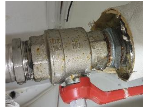
Rustdannelse på galvaniseret rør
