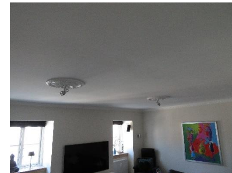
Loft uden revner
