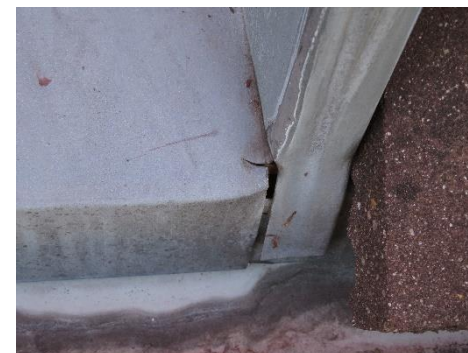
Mindre revne i zink-inddækning
