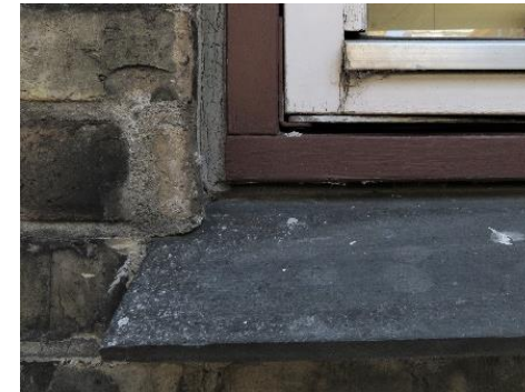
Blød fuge omkring vindue
