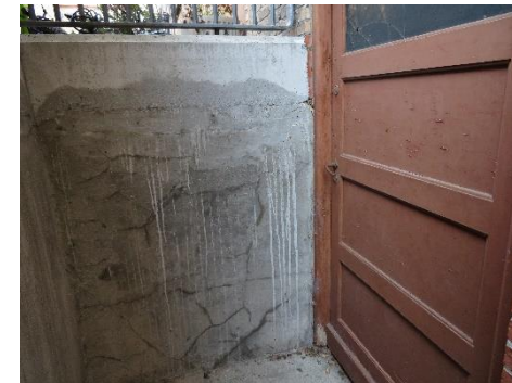
Saltudtrækning i be- ton
