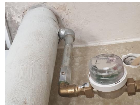
Nyere galvaniseret stål i på gammel varmtvandsinstallation
