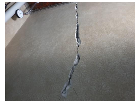
Sætningsrevne på køkkentrappe
