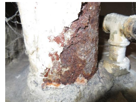
Tæring på støbejernsfaldstamme
