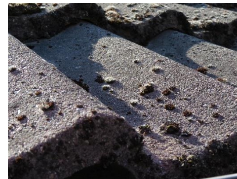
Betontagsten med let mosvækst
