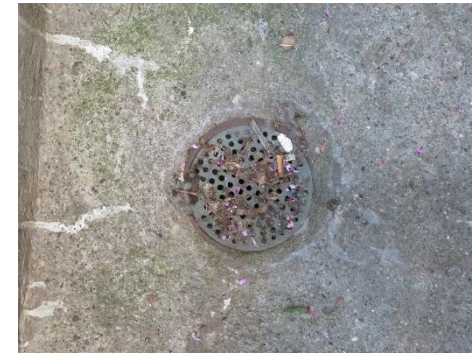
Gulvafløb i kældertrappe
