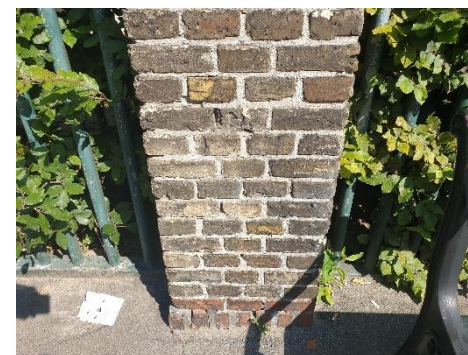
Port søjle i dårlig stand
