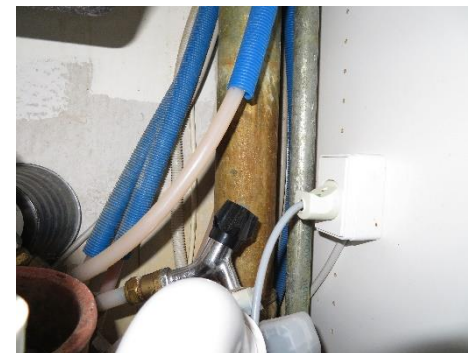
Loro-X faldstamme med nedbrydning af galvaniseret overflade
