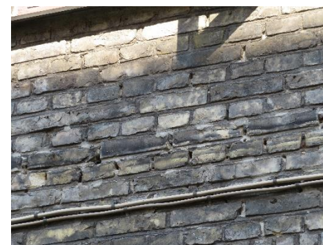
Manglende fuger ved nedtagne kabler
