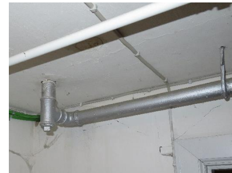
Gasrør i kælder
