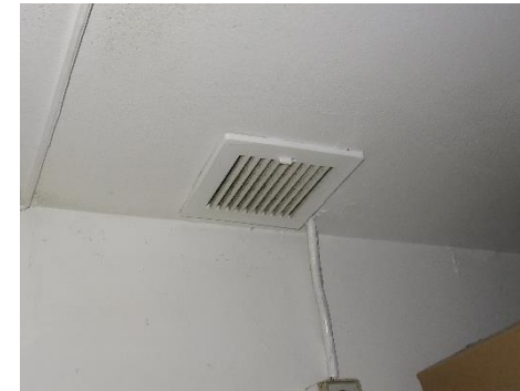
Ventilationskanal i køkken
