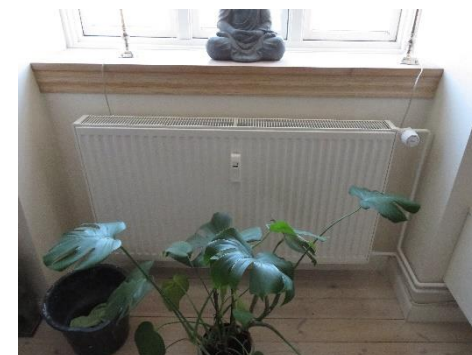
Radiator i lejlighed under vindue
