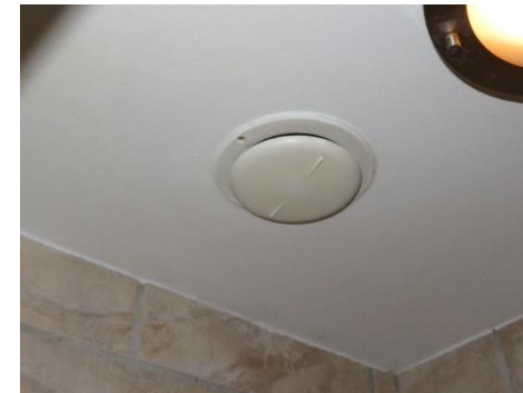
Ventilationskanal i badeværelse
